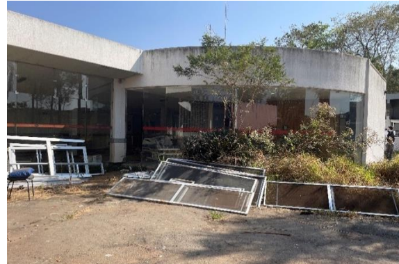
Figura 100. Entrada do complexo violada.
