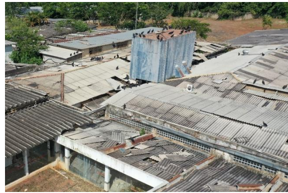
Figura 99. Telhado do complexo deteriorado. Presença de urubus.
