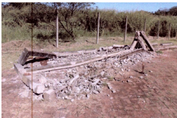
Figura 3. Vista lateral direita do “Pórtico em concreto armado” – colapso recente
