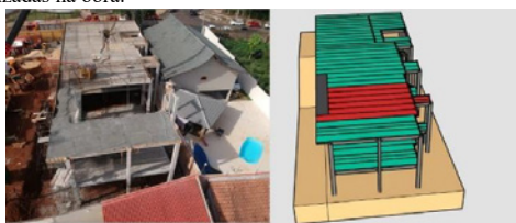
Figura 2. Lajes desabadas in loco e ilustração 3D. Fonte: Autores
