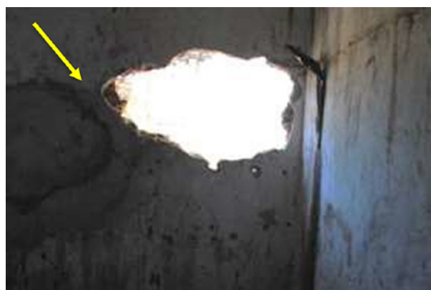
Figura 4. Parede arrombada vista do interior da sala do posto de gasolina.
