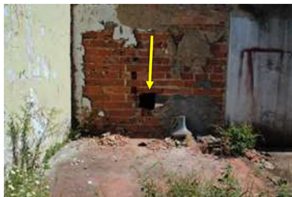
Figura 3. Parede do lote baldio arrombada.
