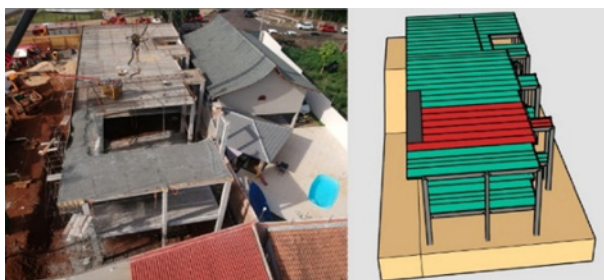
Figura 1. Lajes desabadas in loco e ilustração 3D. Fonte: Autores
