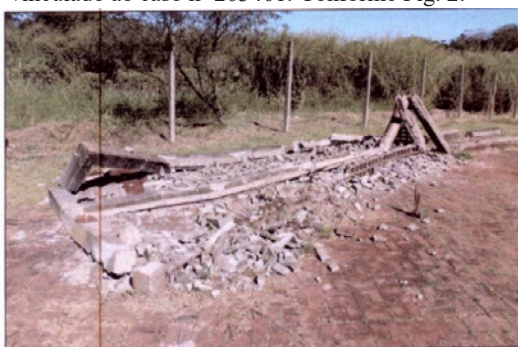
Figura 2. “Pórtico em concreto armado” – colapso recente
