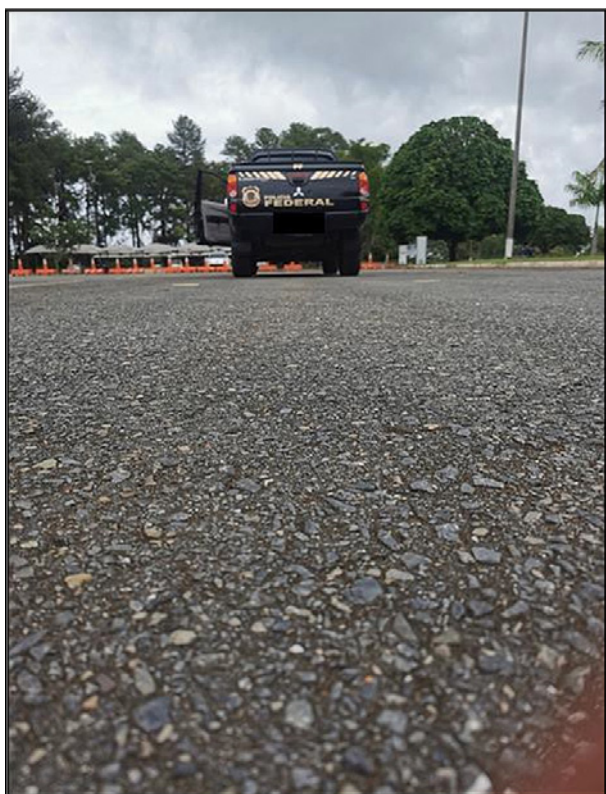
Figura 7. Aspecto geral do pavimento após a frenagem brusca de um dos veículos com sistema ABS.
