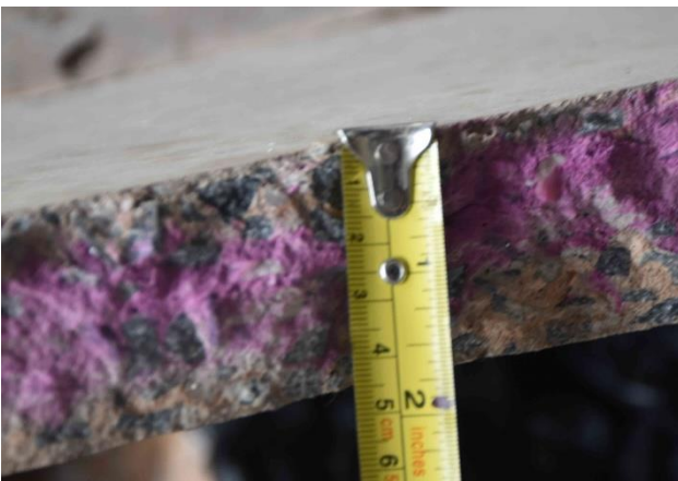
Figura 6. Complementar à Figura 5, mostrando a medida da profundidade de carbonatação (dk) naquele local, em aproximadamente 20 mm. Fonte: Acervo pessoal.
