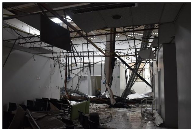
Figura 1. Aspecto geral do sítio do desabamento. Fonte: Acervo pessoal.
