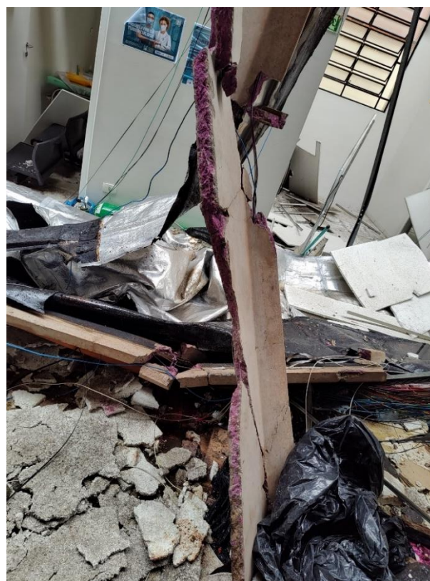
Figura 2. Aspersão de solução de fenolftaleína sobre o perfil da estrutura colapsada, que se achava dependurada no sítio do desabamento. Fonte: Acervo pessoal.
