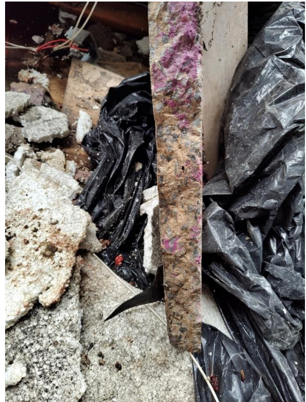
Figura 7. Complementar à Figura 2, mostrando em detalhe a região inferior daquela estrutura, mais próxima do ponto de ruptura da telha. Fonte: Acervo pessoal.
