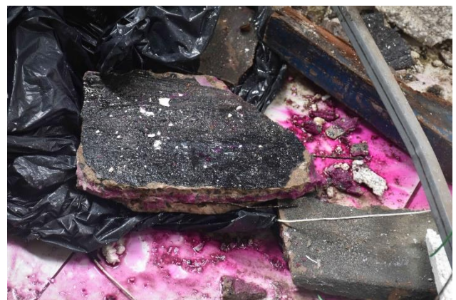
Figura 9. Aspersão de solução de fenolftaleína sobre peça colapsada com armadura exposta. Fonte: Acervo pessoal.
