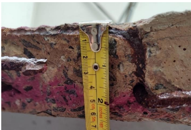
Figura 12. Complementar à Figura 11, mostrando a medida da profundidade de carbonatação (dk) naquele local, em aproximadamente 40 mm na região inferior, atingindo a armadura de aço que, por sua vez, já se achava oxidada. Fonte: Acervo pessoal.
