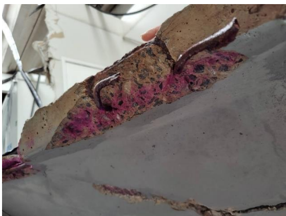
Figura 11. Aspersão de solução de fenolftaleína sobre peça colapsada com armadura exposta. Fonte: Acervo pessoal.
