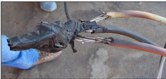
Figura 3. Vestígios de derretimento dos elementos isolantes e marcas de possível combustão em virtude de sobrecargas. Fonte: Autoria própria.
