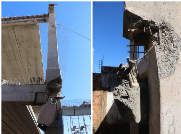
Figura 2. Detalhes do conjunto consolos-pilar rompido. Fonte: Autores
