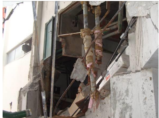
Figura 4. Região de impacto da tampa do reservatório contra a parede do hotel.
