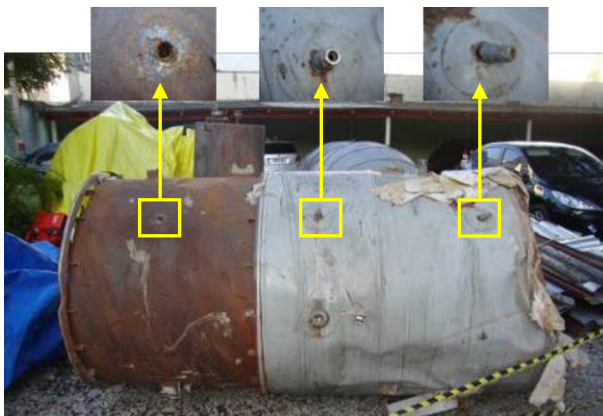
Figura 7. Ausência dos termostatos.
