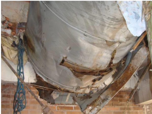
Figura 5. Região de impacto da estrutura do reservatório contra a parede da edificação vizinha.
