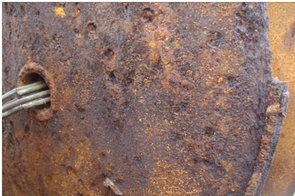
Figura 10. Fragmento metálico pertencente à estrutura do reservatório soldado em sua tampa.
