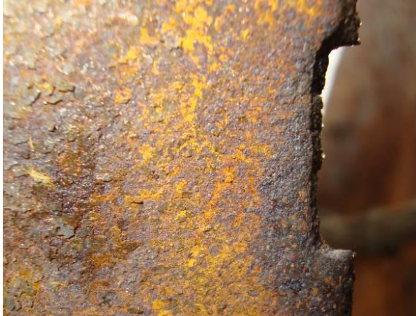
Figura 9. Solução de continuidade na estrutura do reservatório.
