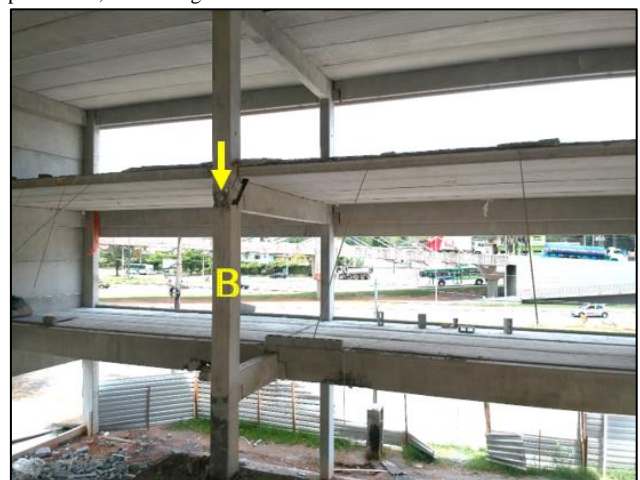
Figura 4. Aspecto geral do pilar B, em imagem efetuada por meio de drone, mostrando no detalhe o local onde se encontrava fixado o consolo, responsável pelo apoio da viga que sustentava a laje do segundo pavimento, em sua região mediana
