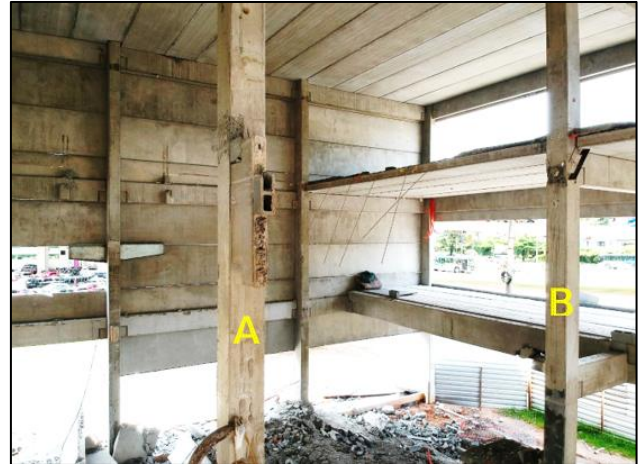
Figura 2. Identificação dos pilares “A” e “B” que sustentavam a viga sobre a qual se apoiavam as lajes do segundo pavimento.
