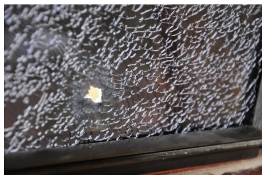
Fig. 20: Evidencia o quarto disparo pela parte interna (4° teste).
